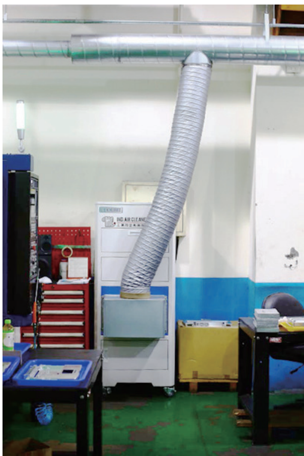
設置 cnc 機台系統油霧回收過濾設備
